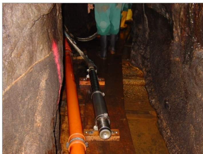
Abb. 3: Grubenwasseranlage Schloss Freudenstein (Foto: K. Hofmann, LfULG)
